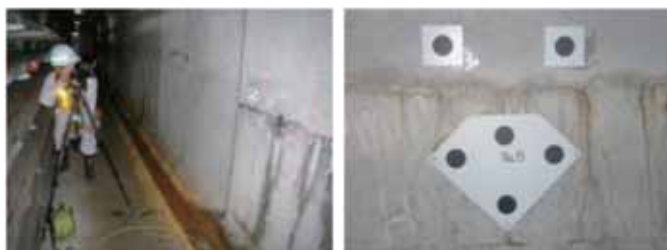
写真-4 ボックスカルパートクラック計測 (現在実施中)
